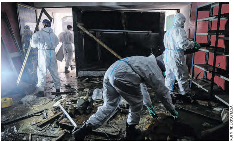
Alcácer do Sal. Depois das inundações, é tempo de limpar e reparar o rasto de destruição deixado pelas águas do rio Sado.
