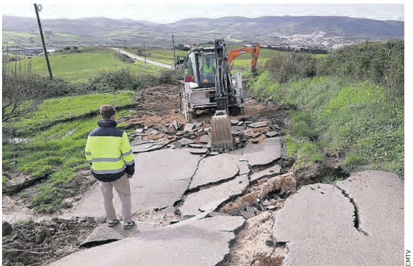
Arruda dos Vinhos. O concelho foi um dos mais afetados com o colapso de estradas. As obras de reparação estão em curso.
