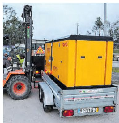
Gerador a ser instalado
